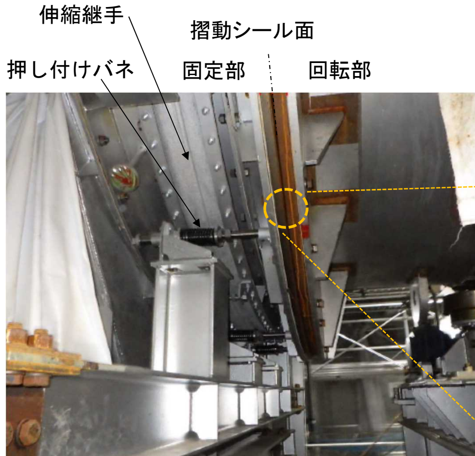
ロータリーキルン シール部(入口側)
