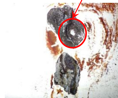
前処理フィルタ2B 漏えい箇所
