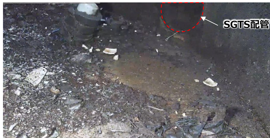
写真：SGTS配管状況(5/20雨天時)
