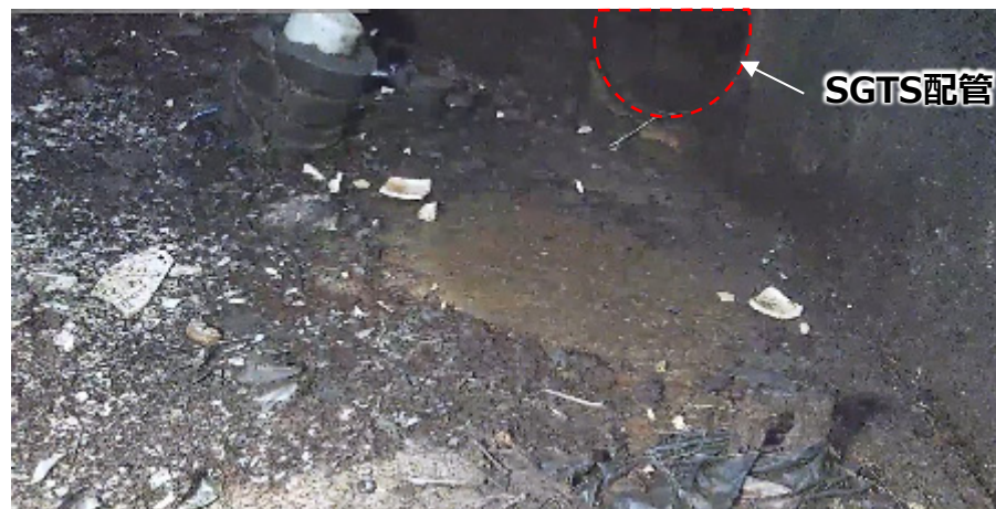
写真：SGTS配管状況(5/20雨天時)
