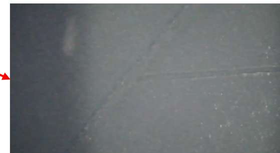
H2-D1タンク内面写真（底板）
