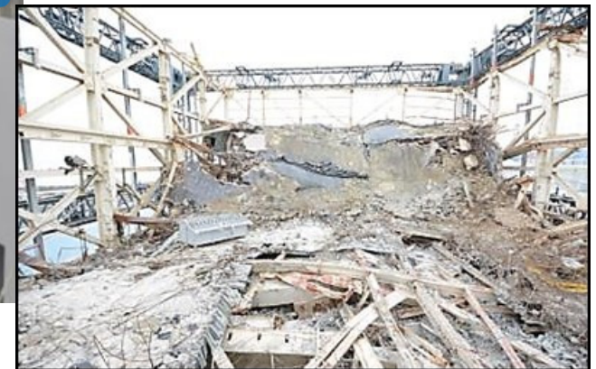
崩落屋根の状況
