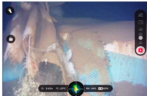
破損している土嚢
