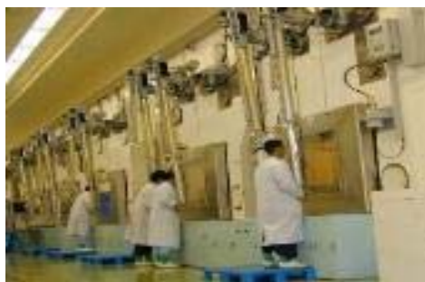
図：燃料デブリ分析設備 （コンクリートセル）の例
