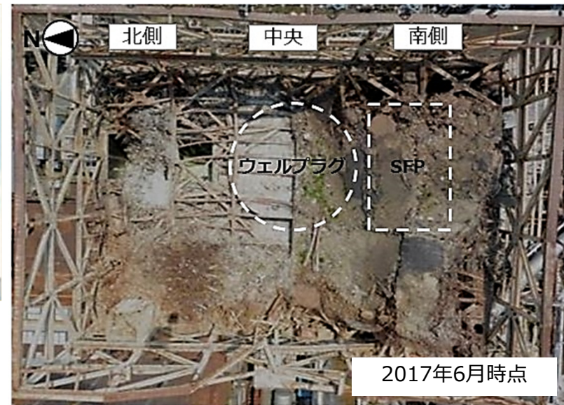
オペフロ上の崩落屋根状況（平面）
