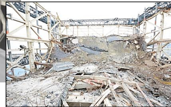
崩落屋根の状況
