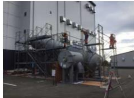
ベント管1/1スケール試験
