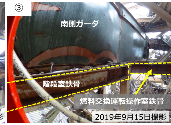
2019年9月15日撮影 南側ガーダの接触状況
