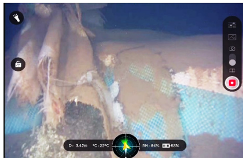
破損している土嚢
