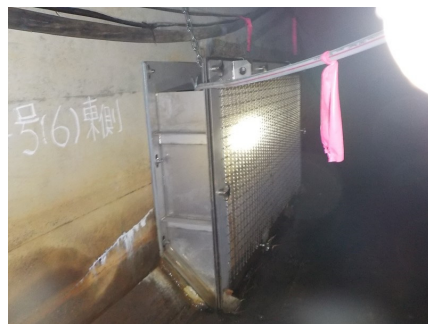
枝管に設置している浄化材の一例
