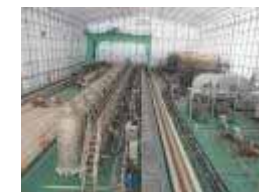
(高性能多核種除去設備)
