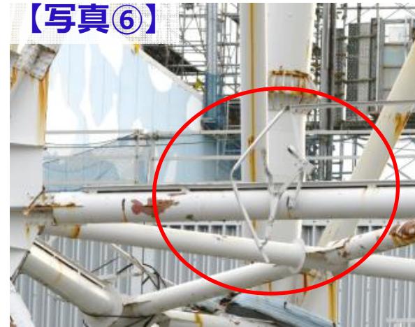
1/2号機 変形した手摺り 北面 地上30m付近
