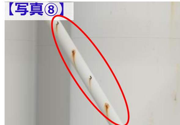
タービン建屋集中 劣化が疑われるステップ 南面 地上32m付近
