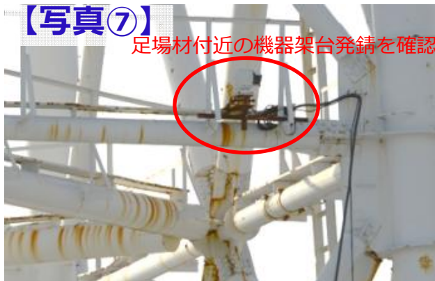
タービン建屋集中 劣化が疑われる機器 北面 地上42m付近
