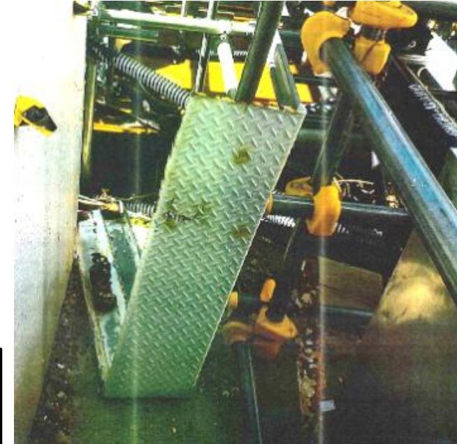
落下した点検用の足場
