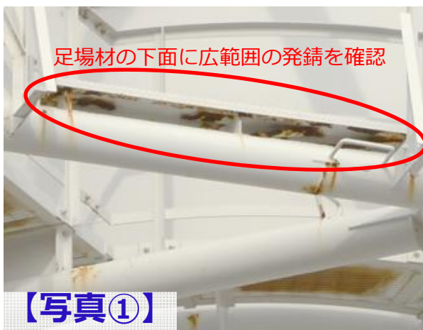
3/4号機 劣化進行が疑われる足場材 北面 地上67m付近
