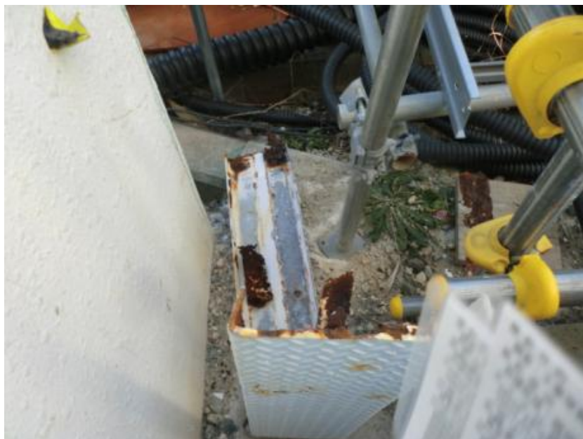
落下した足場
