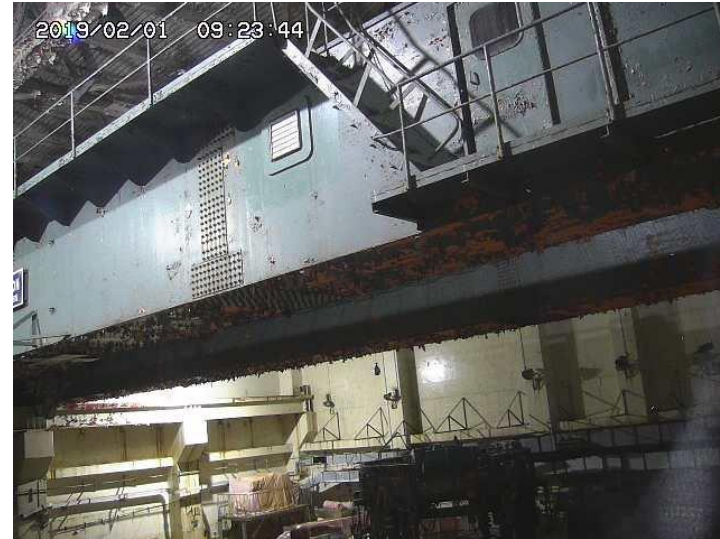
【天井クレーン】
