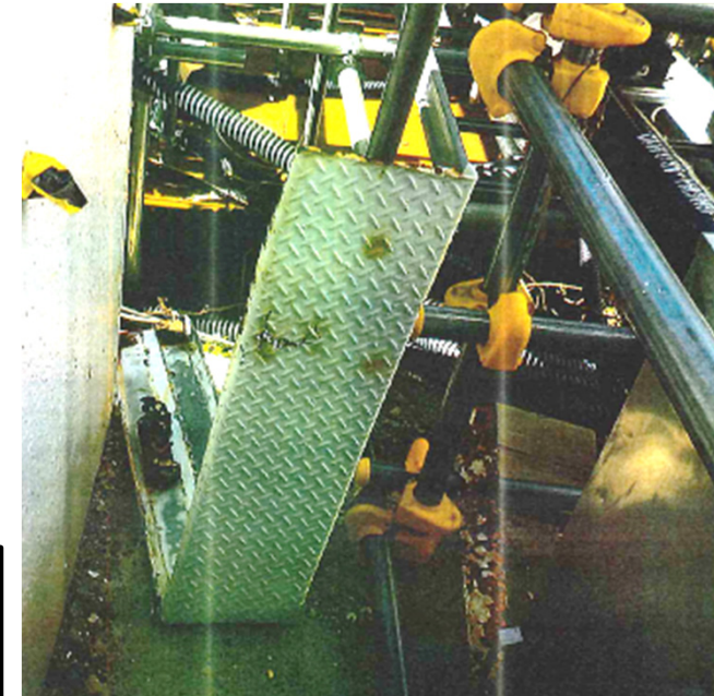
落下した点検用の足場
