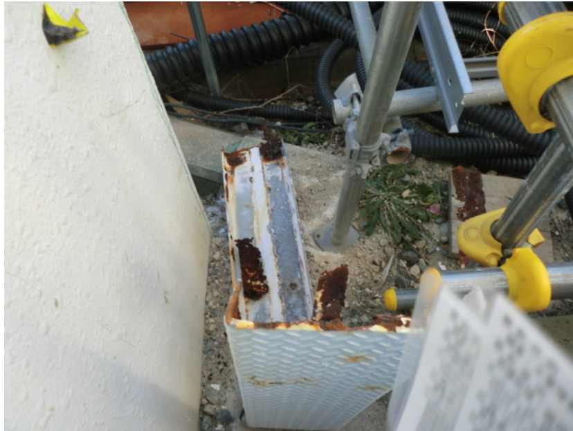
落下した足場
