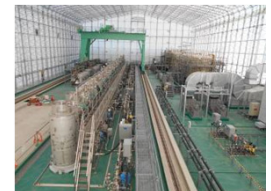
(高性能多核種除去設備)
