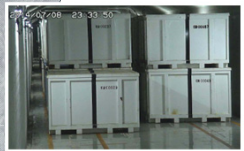
固体廃棄物貯蔵庫
