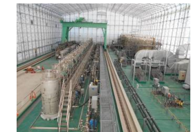
(高性能多核種除去設備)
