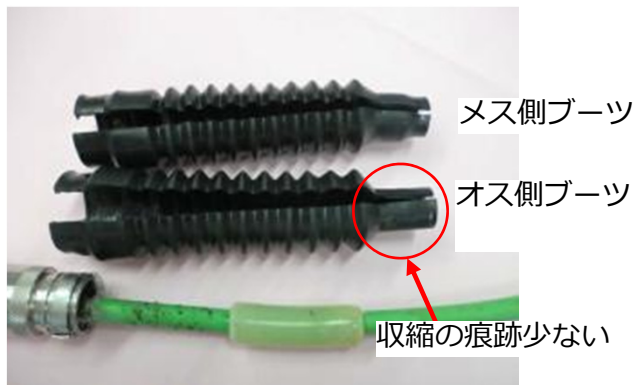
②ブーツの熱収縮状況
