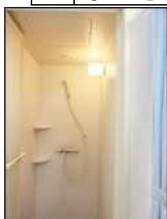
シャワー設備
