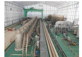
(高性能多核種除去設備)
