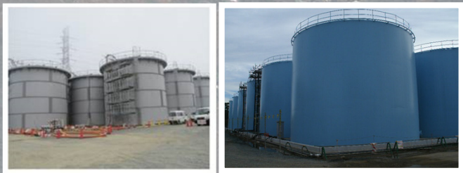
タンクの設置状況
