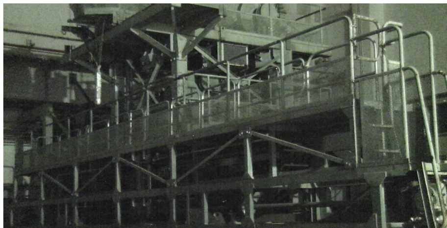
① 【燃料取扱機】
