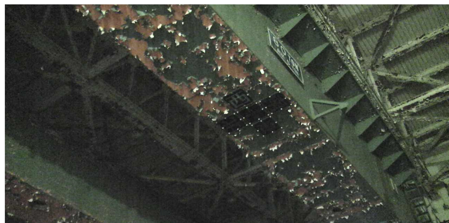
② 【天井クレーン】
