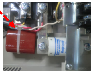
損傷の確認されたヒューズ (4月25日)
