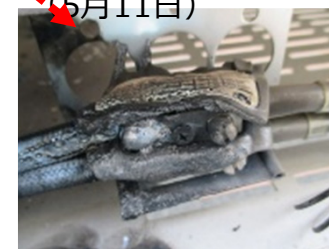
ブレーキレジスタ内の損傷 (5月12日)
