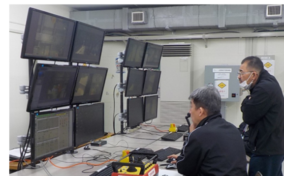
試運転実施状況（遠隔操作室）
