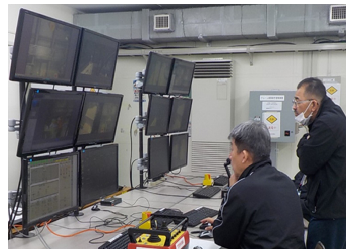
遠隔操作室 試運転状況
