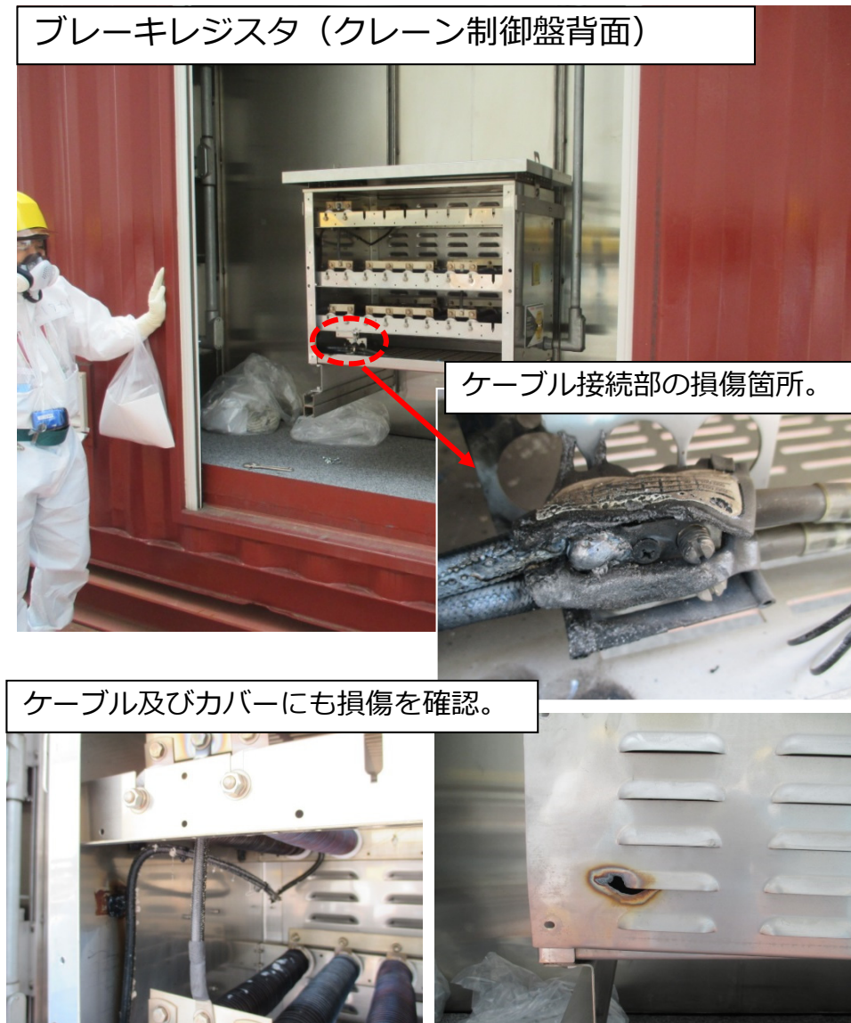
ブレーキレジスタ損傷状況 (撮影日2018年5月12日)
