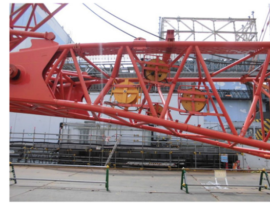
図3 800tクレーン ジブ損傷不具合
