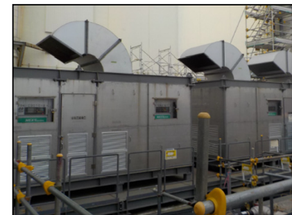
空気圧縮機現場写真
