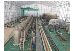
(高性能多核種除去設備)
