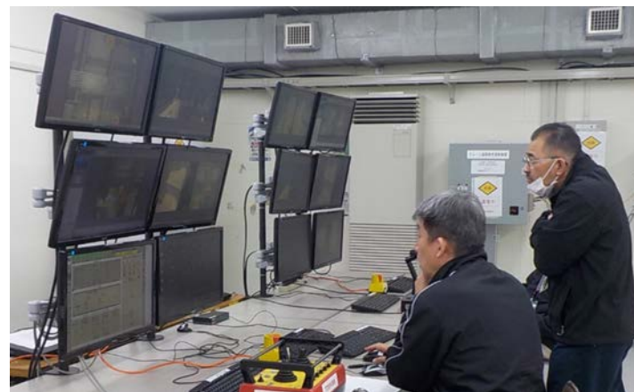
試運転実施状況（遠隔操作室）
