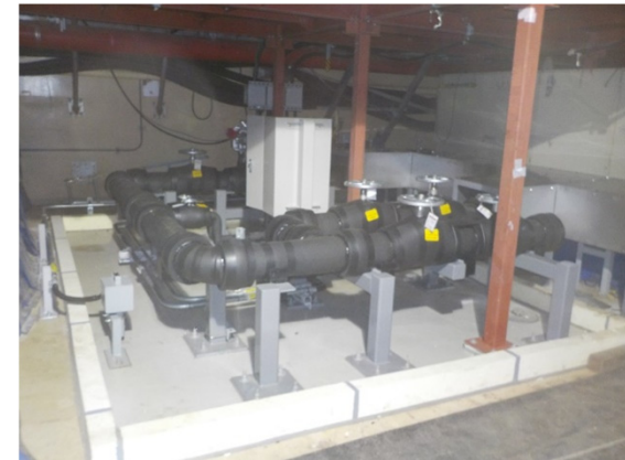
写真：4号機 滞留水浄化配管
