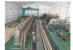
(高性能多核種除去設備)
