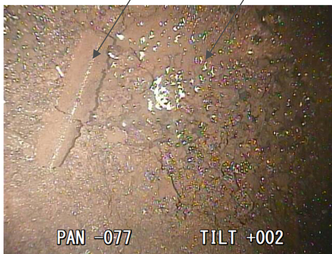
撮影場所B ペDESTAL底部
