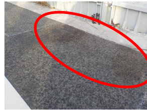
① G 3 北側 漏えい箇所 (仮設ホース端 部漏えい)
