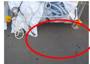
② G 4 北側 漏えい箇所 (資材ラック 前)
