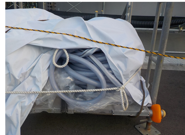
【漏えい2】 仮設ホース保管状況写真
