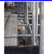
(凍結管バルブ開閉操作の様子)
