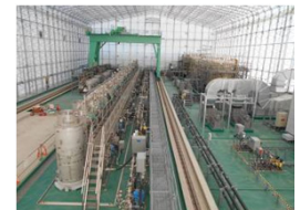
(高性能多核種除去設備)
