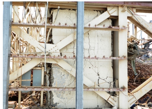
西面の壁状況
