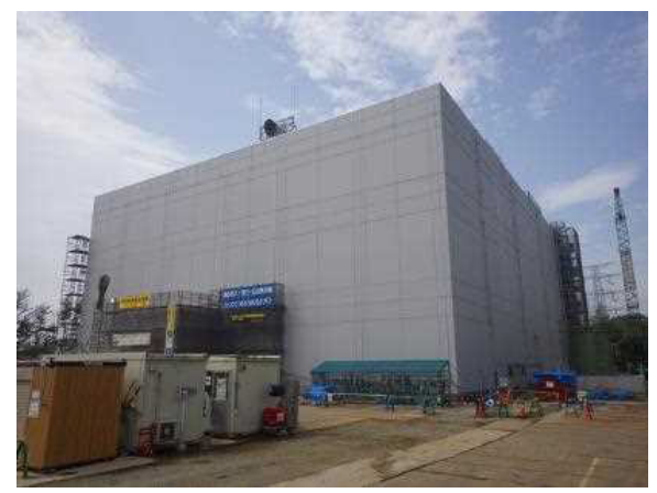
雑固体廃棄物焼却設備（建屋全景）
