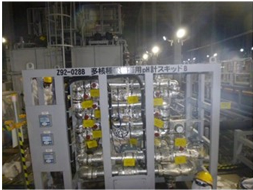
吸着塔用 pHスキッド全景
