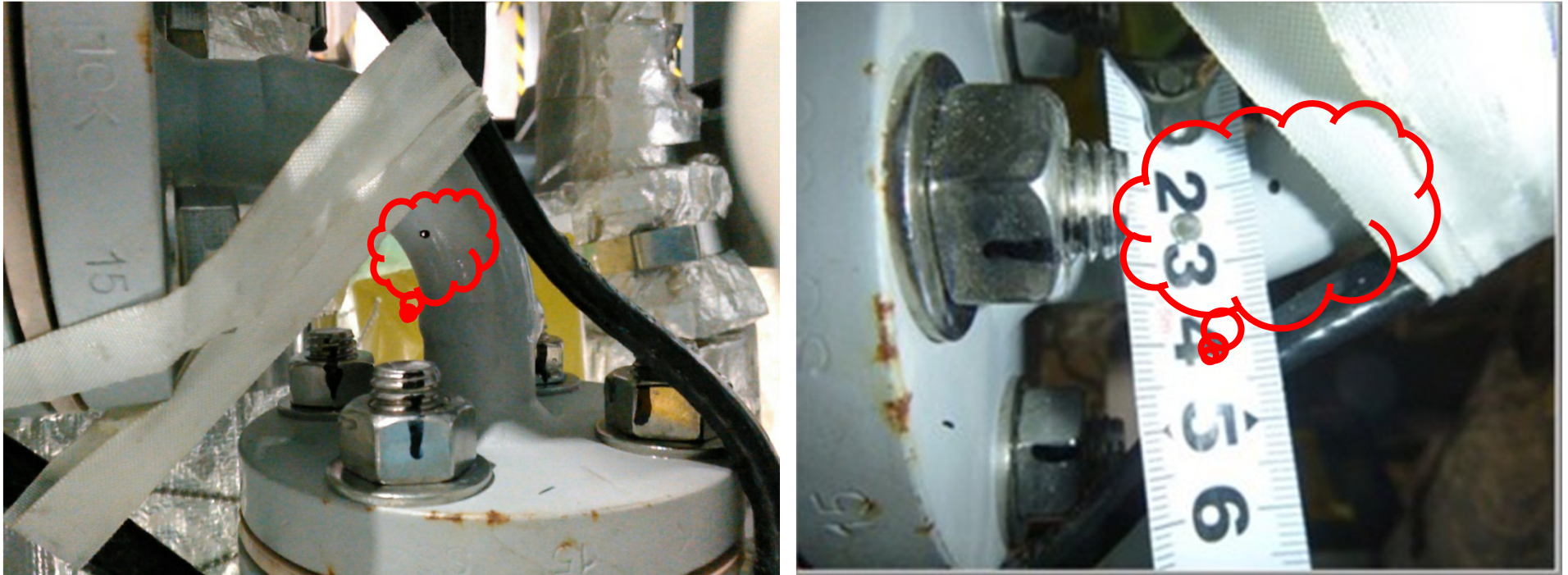
漏えい箇所拡大
