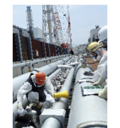
(凍結管バルブ開閉操作の様子)
