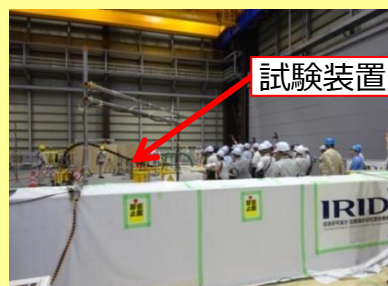
試験棟内（作業フロア上）
