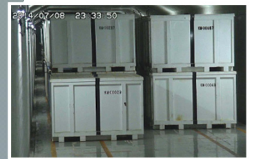
固体廃棄物貯蔵庫
