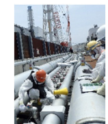
(凍結管バルブ開閉操作の様子)
