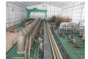
(高性能多核種除去設備)
