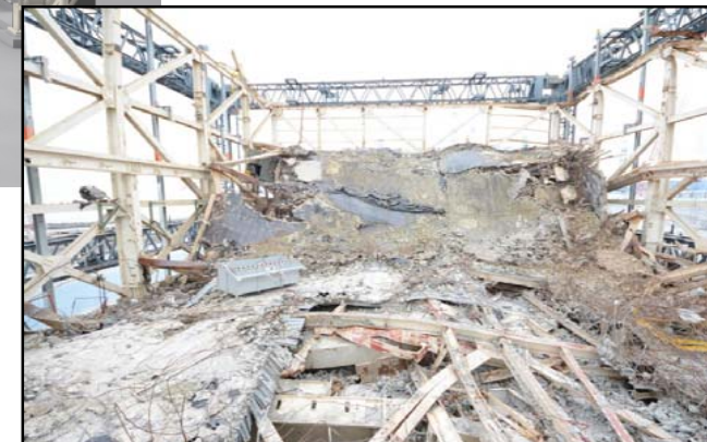
崩落屋根状況
