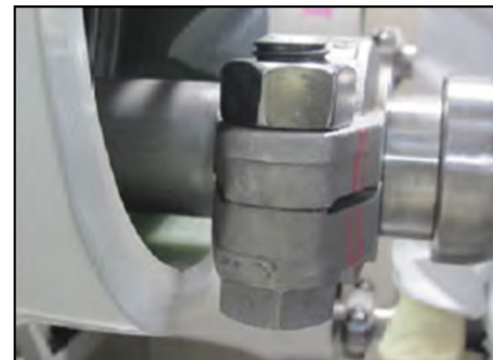
【仮復旧後】配管芯ずれ確認
