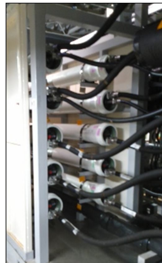
ROユニット(B)現場状況
