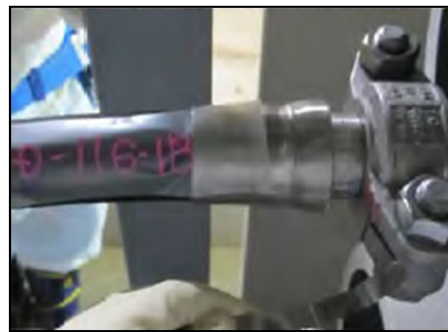
【分解前】隙間確認
