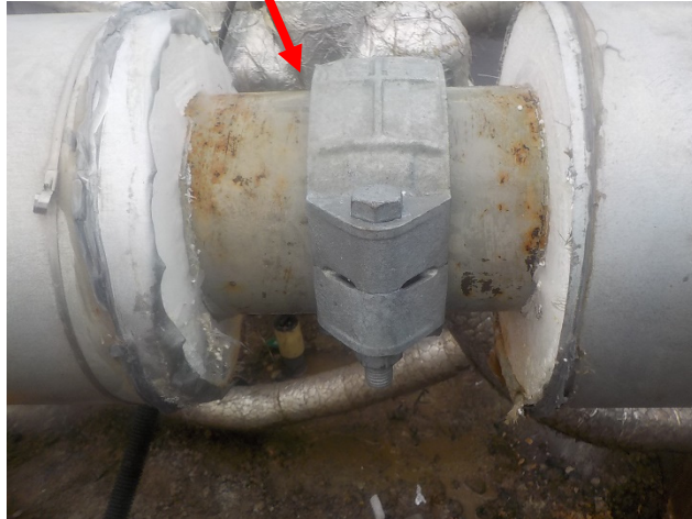
12/20 漏洩元特定 (ヘッダー管ジョイント部)
