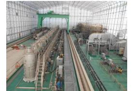
(高性能多核種除去設備)
