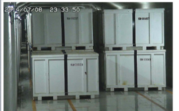
固体廃棄物貯蔵庫
