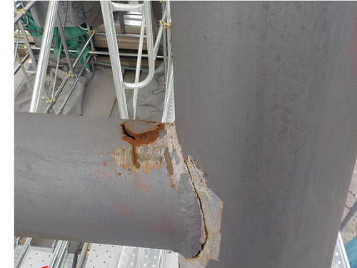
補修前（水平材）
