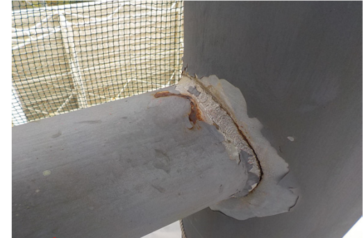
補修前（水平材）
