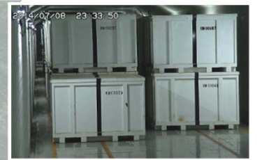
固体廃棄物貯蔵庫
