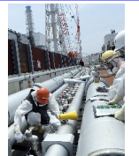
(凍結管バルブ開閉操作の様子)
