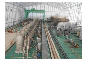
(高性能多核種除去設備)
