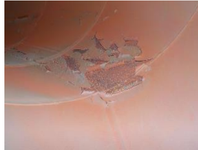
<バグフィルタB出口側煙道>
