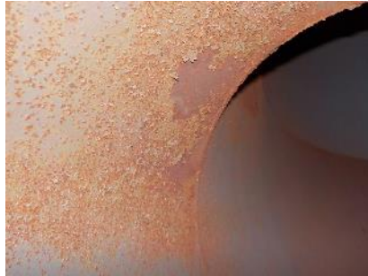
<排ガス補助ブロアB入口側煙道>
