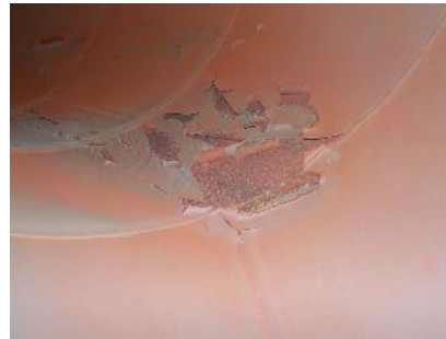
<バグフィルタB出口側煙道>
