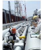
(凍結管バルブ開閉操作の様子)
