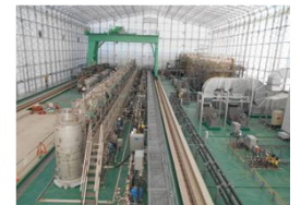
(高性能多核種除去設備)
