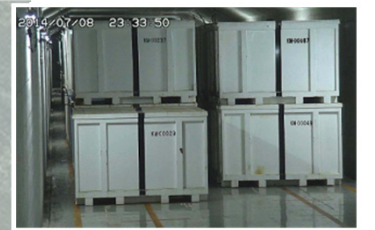
固体廃棄物貯蔵庫
