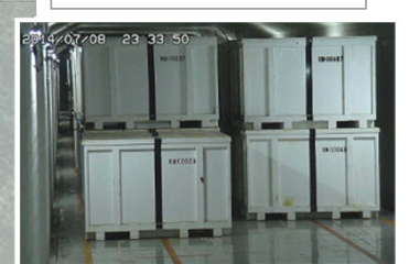
固体廃棄物貯蔵庫
