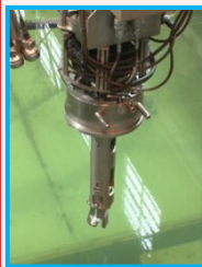
燃料取扱機（マスト） 燃料取扱設備（工場内設置状況）
