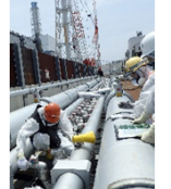
(凍結管バルブ開閉操作の様子)
