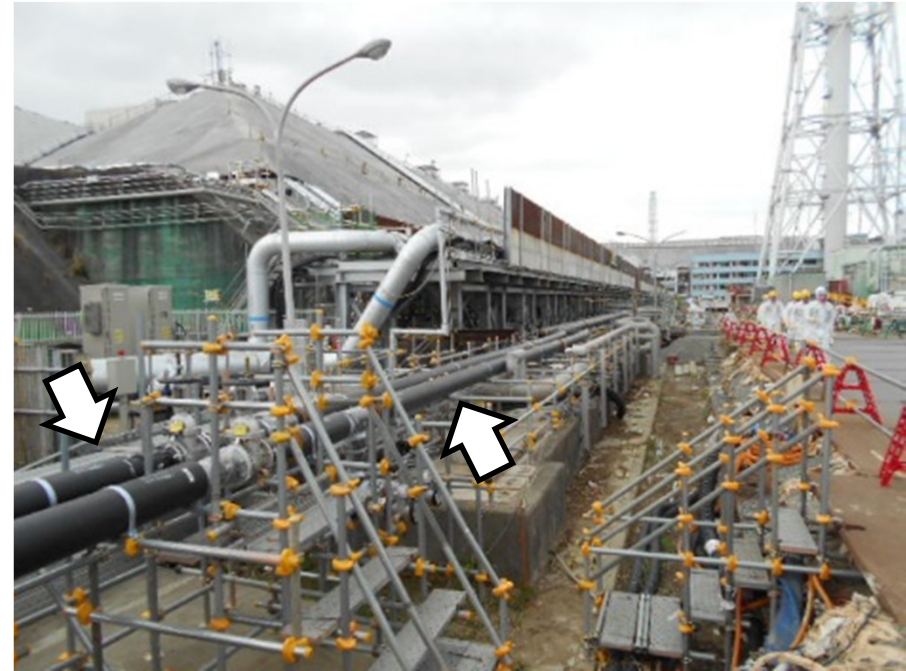
二次系配管 （1～3号機原子炉建屋西側道路脇）
