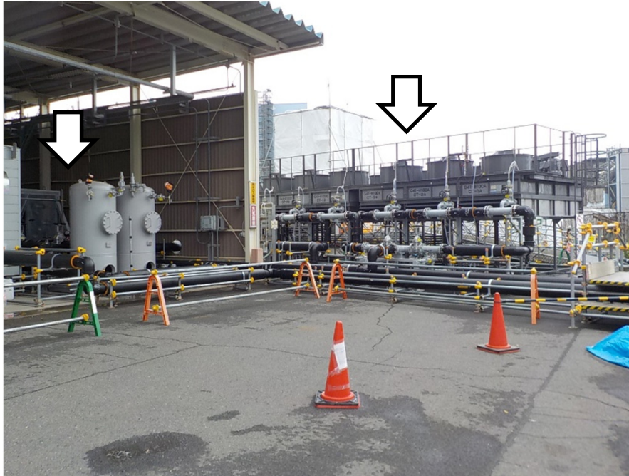
二次系冷却設備（ポンプ，エアフィンクーラー） （1．2号機超高圧開閉所南側エリア）
