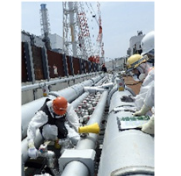
(凍結管バルブ開閉操作の様子)
